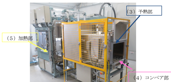
図 7：小型プラントの外観 2
